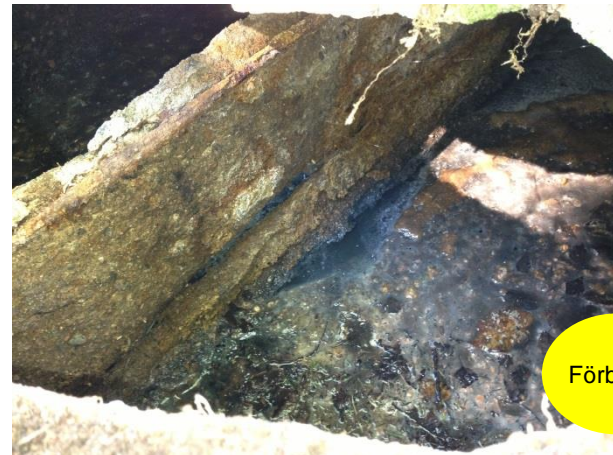
Mellanväggarna är dåliga.
